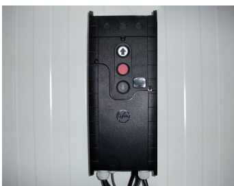
Armoire de commande à porte rapide frigorifique.
