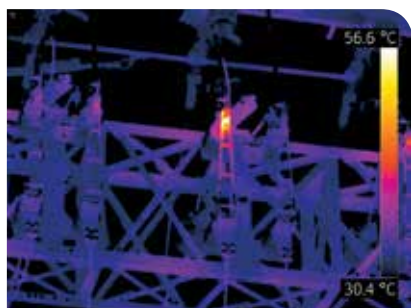
Disjoncteur de poste électrique en surchauffe
