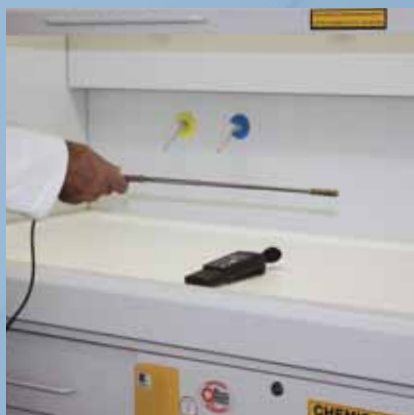
ESSAIS AVEC UN ANEMOMETRE
